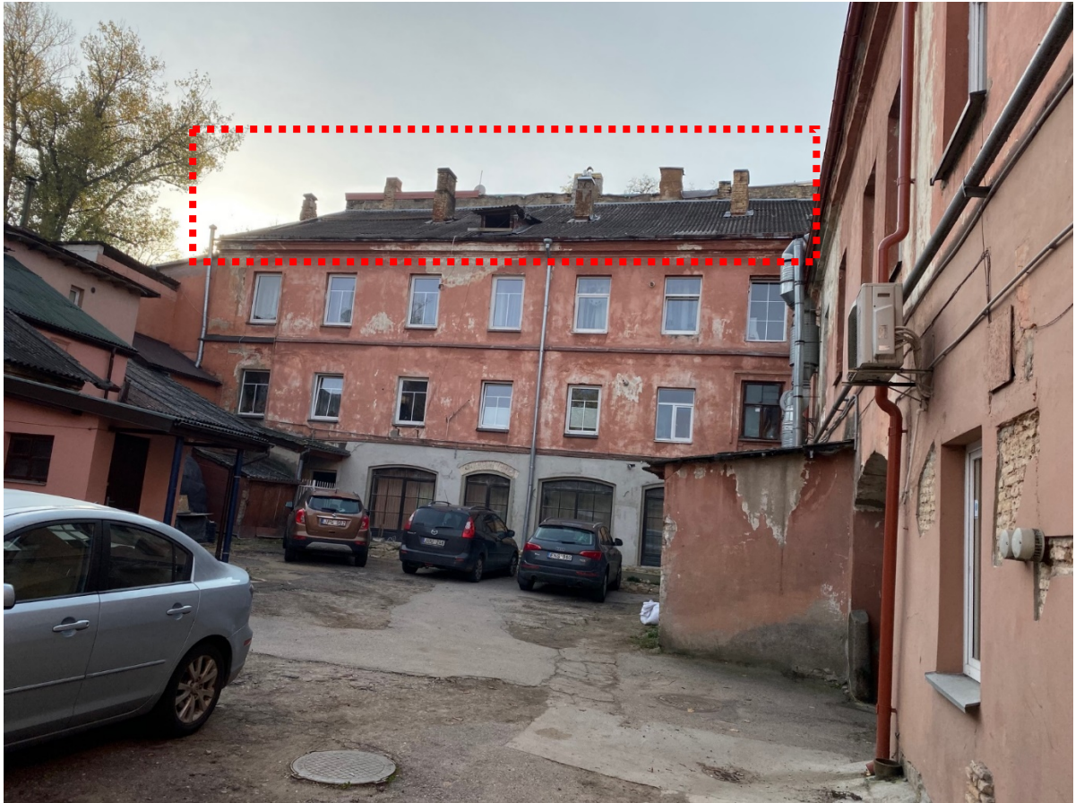
Aušros vartų 18 kiemo korpusas, avarinės būklės pastogė
