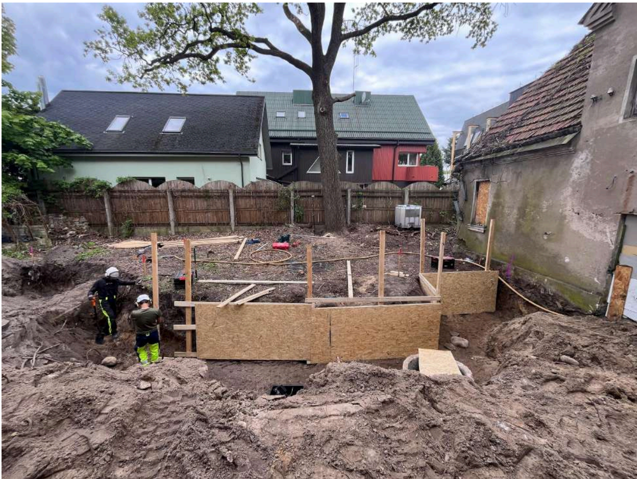
Pav. 4.3.7. Revizijos metu buvo atlikta ažuolo šaknų redukcija bei įrengtas atitvaras apsaugai statybų metu.
