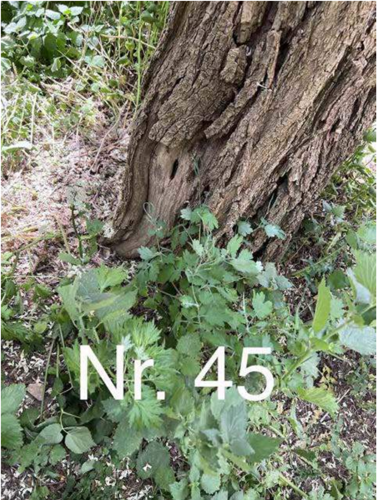
Baltažiedė robinija (nr. 35 plane) - kamienas stipriai pasviręs pietų kryptimi. Didžioji lajos masė taip pat susiformavusi pietų kryptimi. Priešingoje pusėje pažeistas šaknų kaklelis. Rekomenduojama atlikti lajos priežiūros genėjimą ir pietinės pusės lajos redukcinį genėjimą iki 20 proc. Atlikti augavietės gerinimo (revitalizacijos) procedūras. Atlikinėti nuolatinį būklės monitoringą.
