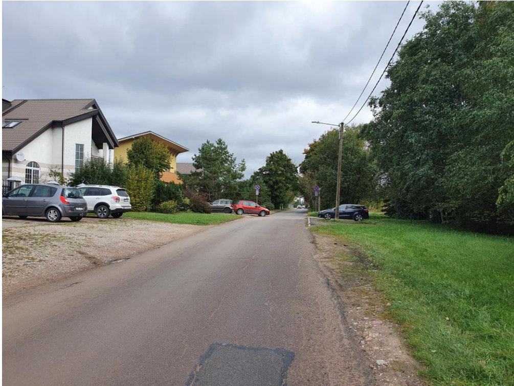
5 pav. Lietaus g. techninė būklė (gatvės nagrinėjamos atkarpos pabaigoje vyrauja privatūs gyvenamieji namai)
