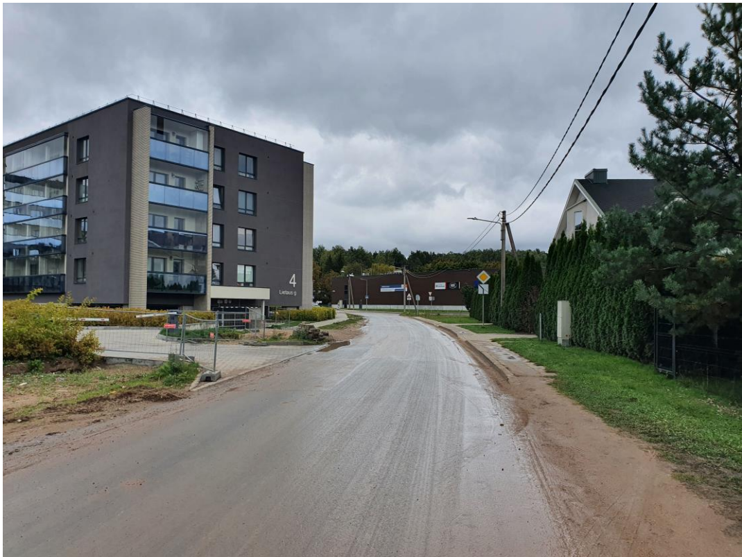
3 pav. Lietaus g. techninė būklė (gatvės pradžioje esami daugiaaukščiai gyvenamieji pastatai)
