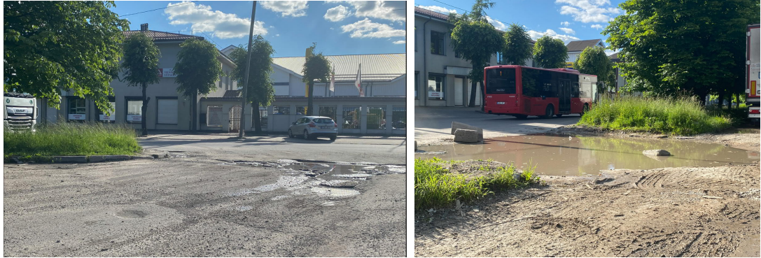
3 pav. Įvažiavimų / išvažiavimų dangos būklė
