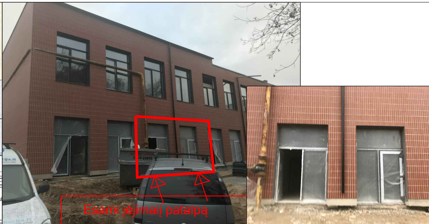
Patalpų vieta pastate
