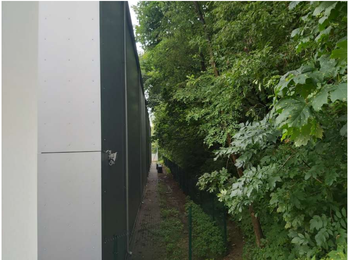
Pietinės sklypo ribos šlaito medžiai pilnai dengia erdvę iki pastato. Saulės ši vieta negauna niekada. Todėl nėra tikslinga sodinti sumedėjusius želdinius šioje vietoje.
