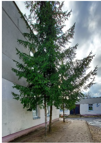
Eglių grupė augantį palei fasadą. Planuojama šalinti.
