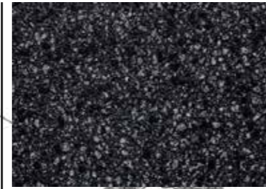
Pėsčiųjų takas tvarkomoje parko teritorijoje. Pigmentuotas asfaltas su granito skalda viršutiniame sluoksnyje [Nešlifluotas]
