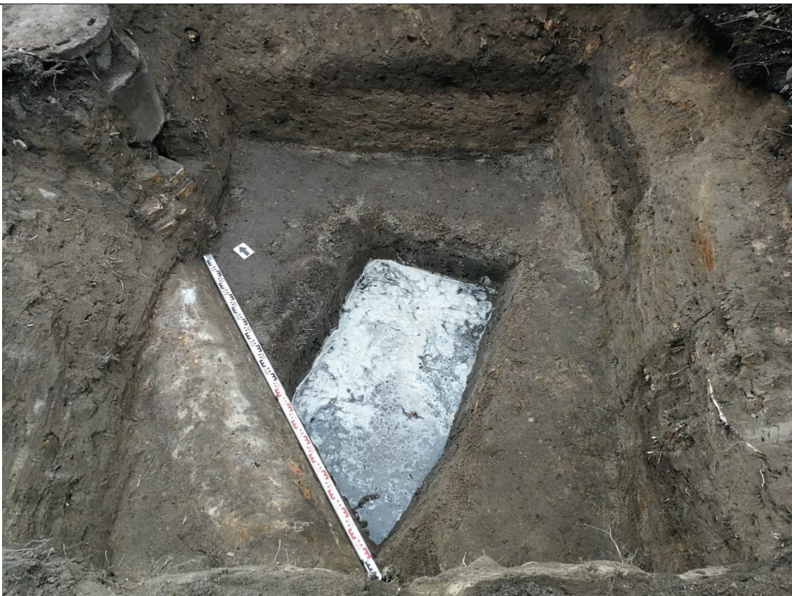
F.03. Šurfas nr. 3 dugne atidengto kolektoriaus viršaus ir šalimais iškasto šurfo, užpildyto gruntiniu vandeniu, vaizdas iš viršaus.
