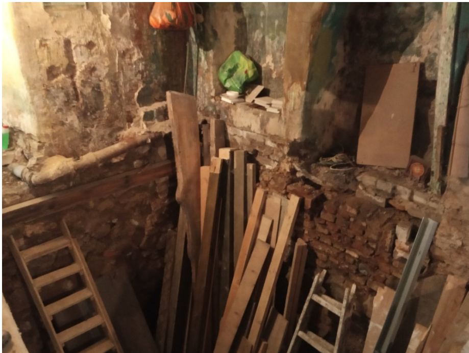
F 6 Po cokolinio aukšto Užupio g. 7-47 patalpomis yra rūsio patalpa. Rūsio sienos akmenų, plytų-akmenų mūro. Perdanga medinė, XX a. II p. etapo, labai blogos būklės, nevertinga.
