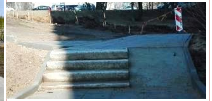
Laiptai nėra saugūs ir patogūs – laiptų pakopos skirtingų aukščių, pandusas per status, neįrengti turėklai. Neįvertinta galimybė šaligatvį įrengti be laiptų.
