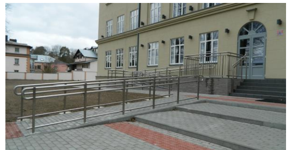
Gerai įrengtas pandusas, tačiau laiptų pakopos per didelės ir nepažymėtos kontrastingos spalvos juostomis
