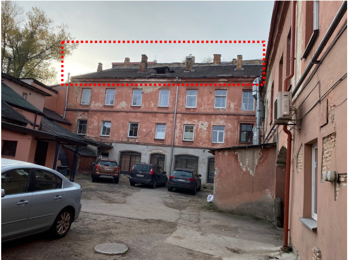
Aušros vartų 18 kiemo korpusas, avarinės būklės pastogė
