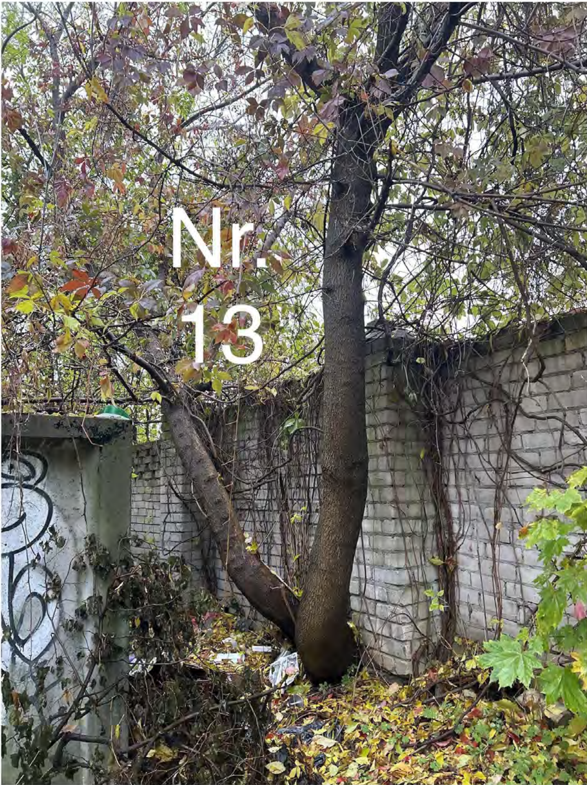
Uosialapis klevas (nr. 13 plane) - auga iš po plytų tvoros, šaknų kaklelis įaugęs į plytas. Nproporcinga laja padidina išlūžimo galimybes. Be perspektyvų. Siūloma šalinti.
