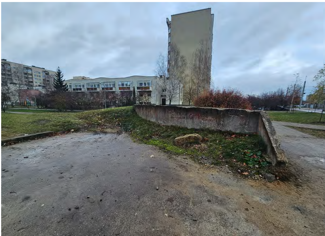
Pav. 37 Dekoratyvinių atraminių sienelių būklė
