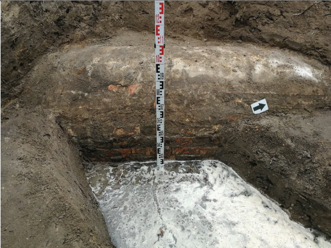
F.04. Šurfe nr. 3 atidengto nuotekų kolektoriaus viršaus ir šoninės, išgaubtos sienos fragmentas.
