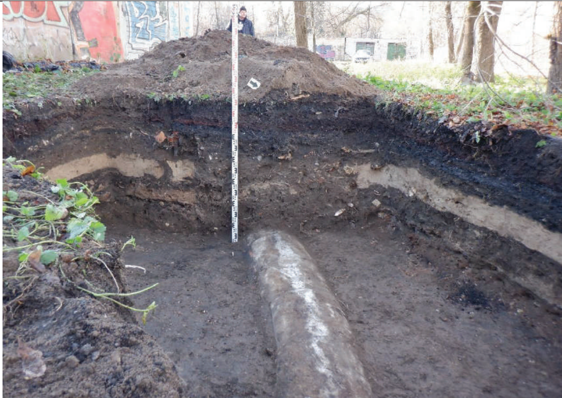
F.06. Perkasoje nr. 1 atidengto nuotekų kolektoriaus fragmento pietrytinė dalis. Pjūvio stratigrafijoje išskiriami dviejų buvusių kiemo paviršiaus horizontai. Tranšėjos, skirtos kolektoriaus statybai įkasimo viršus fiksuojamas maždaug 50 cm gylyje nuo dabartinio kiemo paviršiaus lygmens.
