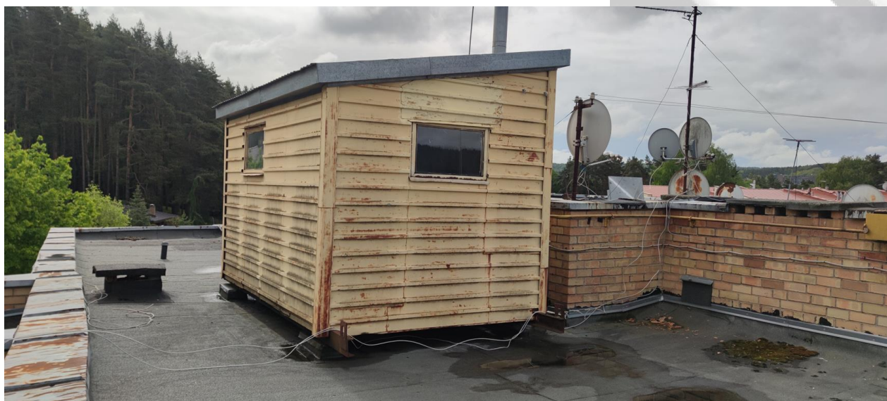
Pav. Nr. 1. Demontuojamos konteinerinio tipo AB Vilniaus šilumos tinklai priklausančios dujinės katilinės.
