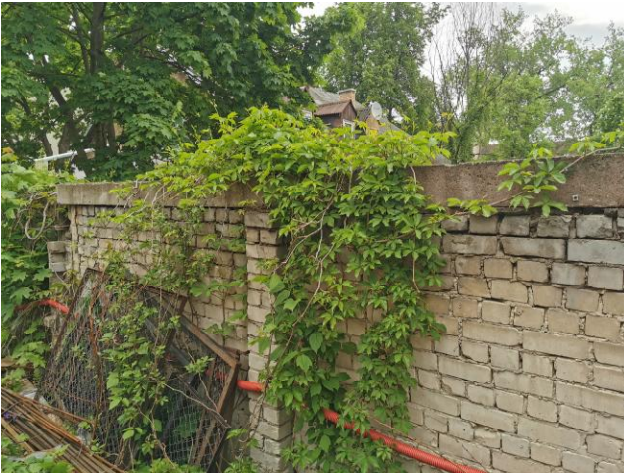
11 pav. Bendras tiriamos tvoros vaizdas, matomas erozijos veikiamas tvoros mūras.
