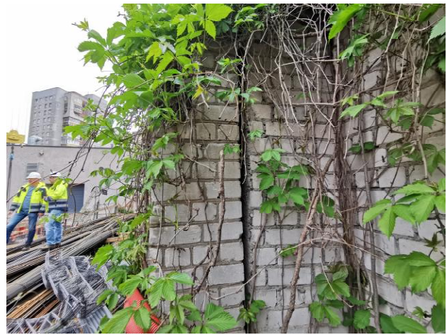
12 pav. Matomas vertikalus plyšys tarp skirtingu metu įrengtų tvoros dalių. Tarp jų buvo skiedinio sluoksnis.
