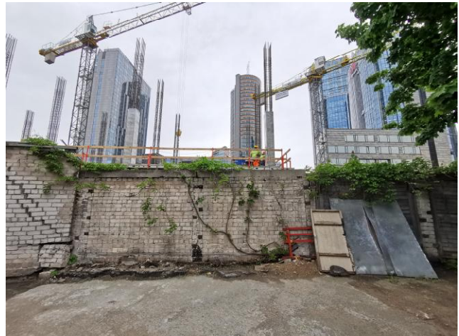
6 pav. Bendras tvoros vaizdas iš Lvovo g. 19A sklypo pusės. Tvoros paviršiuje kairėje pusėje matomi įstriži plyšiai atsiradę dėl tvoros pamato nusėdimo
