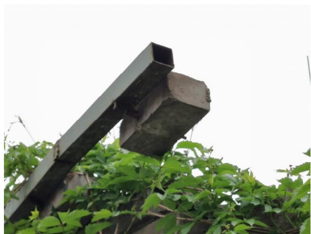
14 pav. Dalis mūro nesaugiai kabo ant plieninių tvoros elementų.
