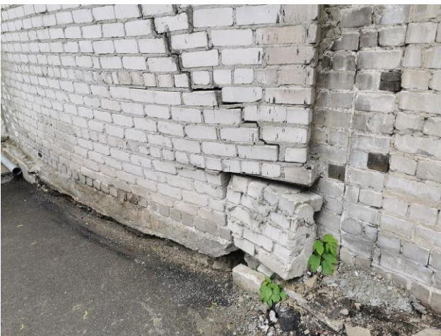
13 pav. Pietinėje tvoros dalyje iš Lvovo g. 19A sklypo pusės matomi įstriži plyšiai, taip atitrūkusi mūro dalis.
