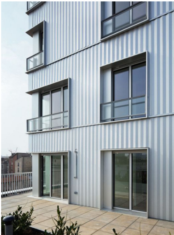
Profiliuotų metalo lakštų fasado apdaila, daugiabutis namas, Plein Ciel, MG-AU ir Michel Guthmann Architecture et Urbanisme (fot. Takuji Shimmura, 2016)
