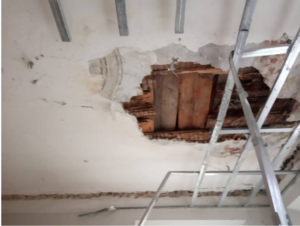
F 17 Pat. 14-3 medinė perdanga ir lubos, tinkuotos ant pakalimo. Dalinai išliko lubų polichrominis dekoras. Lubų karnizas nukapotas "euroremonto" (XX a.pab.) metu. Perdanga avarinės būklės dėl ilgą laiką buvusio kiauro stogo.
