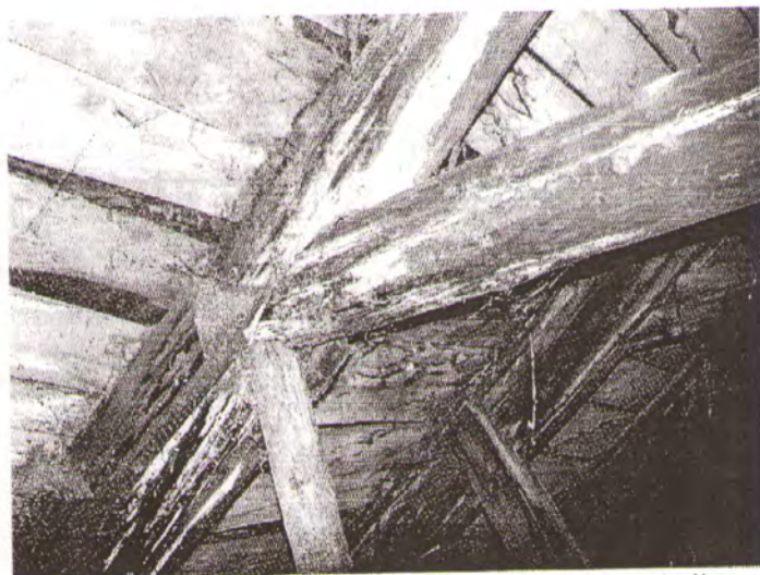
16. Puvinio ir pelėsio pažeisti medinių konstrukcijų mazgai.
