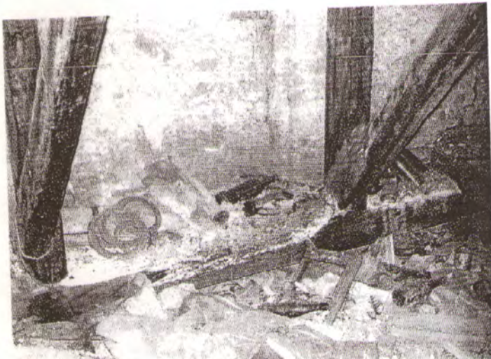
9. Puvinio ir pelėsio pažeistos medinės stogo konstrukcijos.
