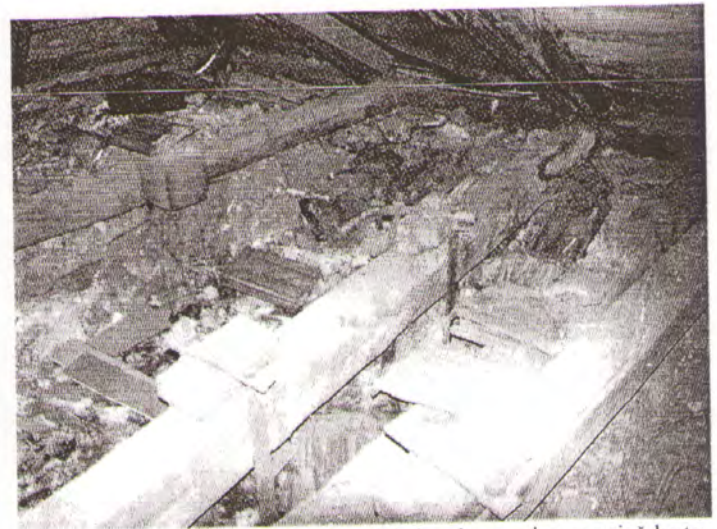
4. Medinės sijos laikančios įlinkusią perdangą virš buto Bernardinų g. 4-14.
