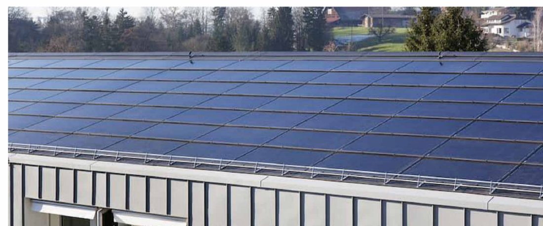
Saulės elektrinė ant stogo (neintegruoti saulės paneliai)
