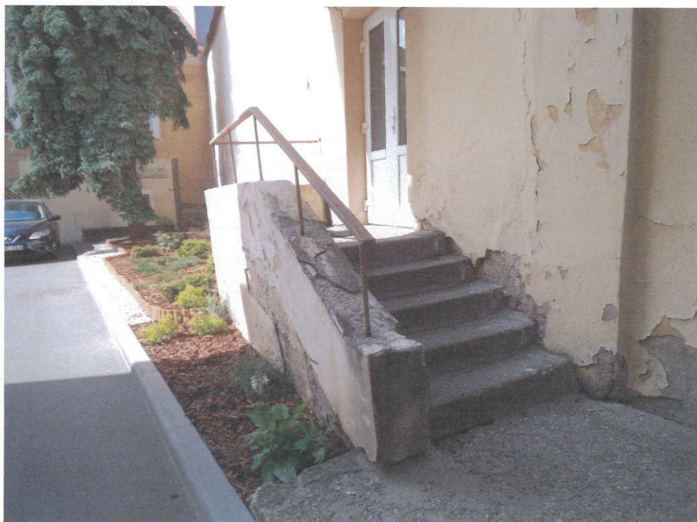
Avarinės būklės laipteliai rytų pusėje
