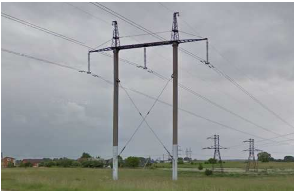
4 pav. Esamos 330 kV OL Lietuvos E-Vilnius gelžbetoninė tarpinė PVS-330A atrama (Nr.7A)
