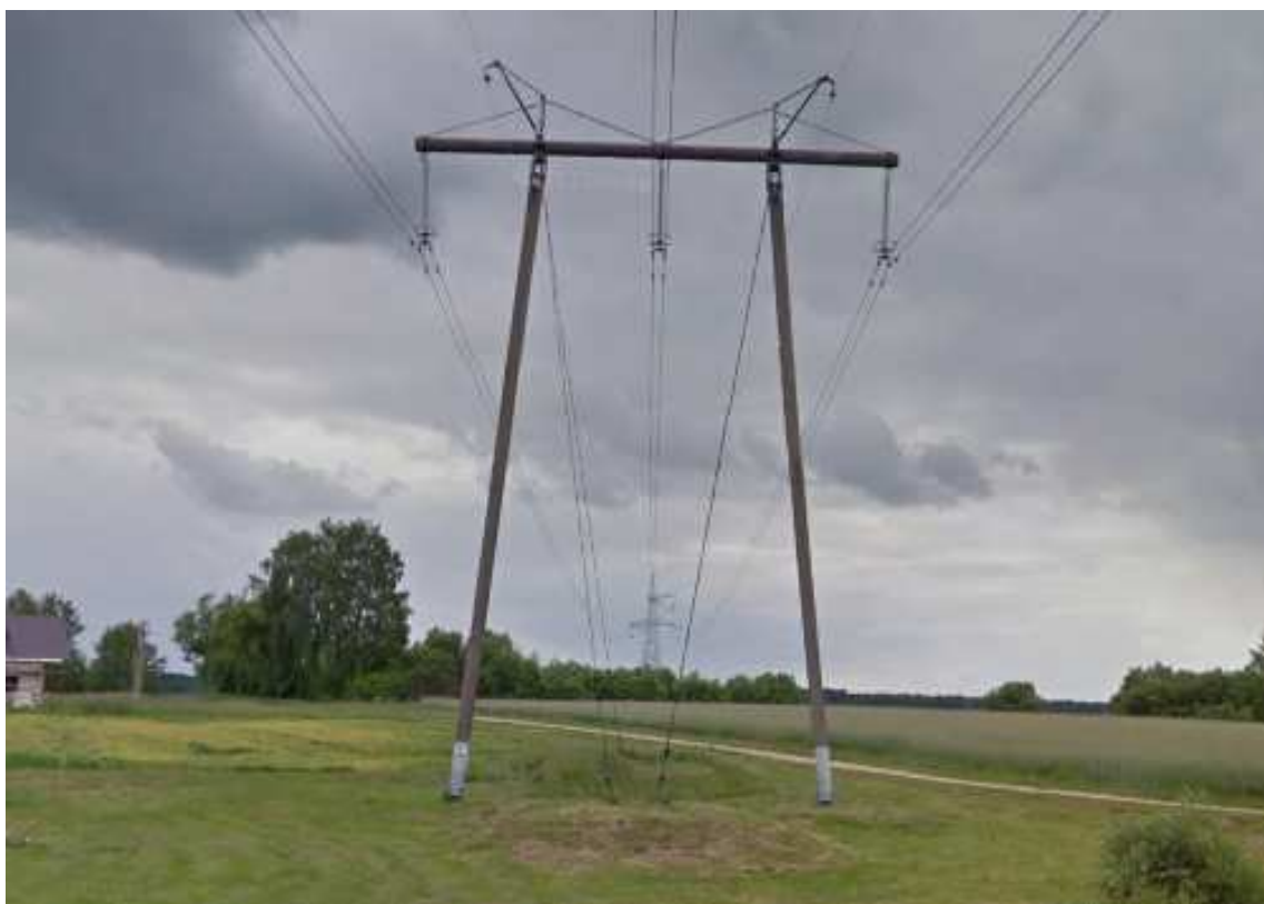
5 pav. Esamos 330 kV OL Lietuvos E-Vilnius gelžbetoninė tarpinė PPOD-8B atrama (Nr. 19/20)
