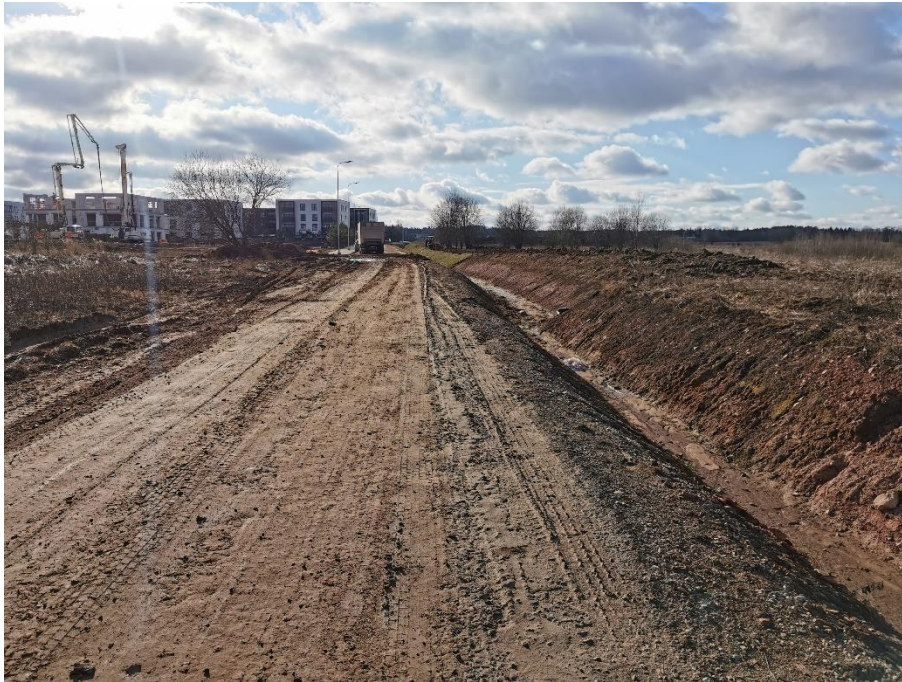
6 pav. Neįrengtos Dangeručio gatvės ruožas
