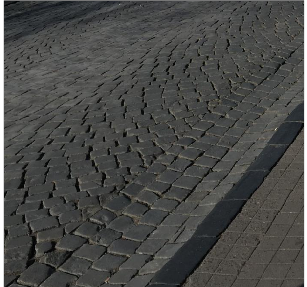
Važiuojamosios dalies latakų ir šaligatvio atskyrimo juodo bazalto trinkelių eilė pavyzdys Pilies gatvėje
