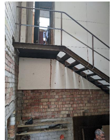
Pav. 18. Avarinės laiptinės fotofiksacija
