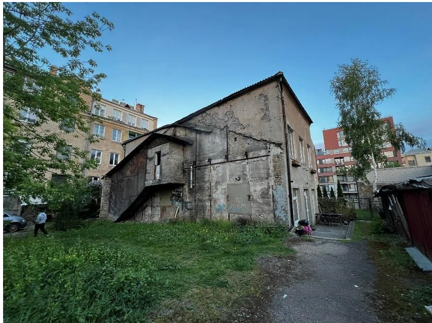
Pastato šiaurės fasadas. Matomas buvusios nugriautos dalies stogo kontūras. Dalis betono sienos apšiltinta medžio drožlių mišiniu.
