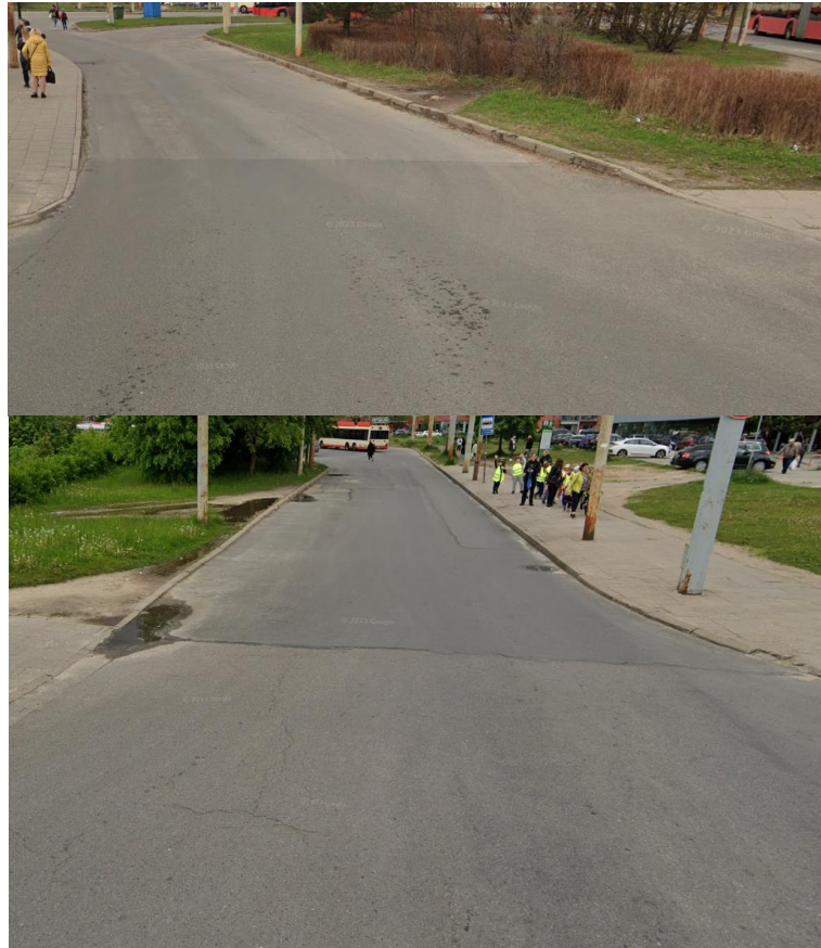
3 pav. Įvažiavimų / išvažiavimų dangos būklė
