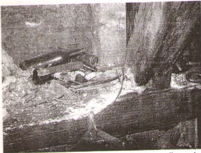
3. Puvinio pažeista medinė sija virš buto Bernardinų g. 4-14, į kurią remiasi stogo konstrukcijos.
