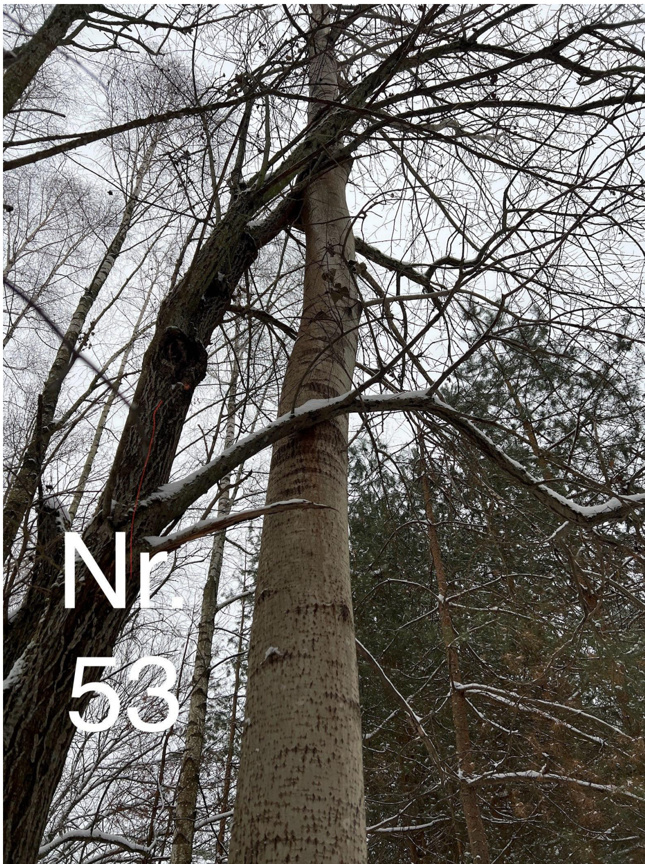
Blindė (nr. 53 plane) - trinasis į brandesnio medžio kamieną. Lajoje nemažas kiekis sausų šakų. Siūloma šalinti.
