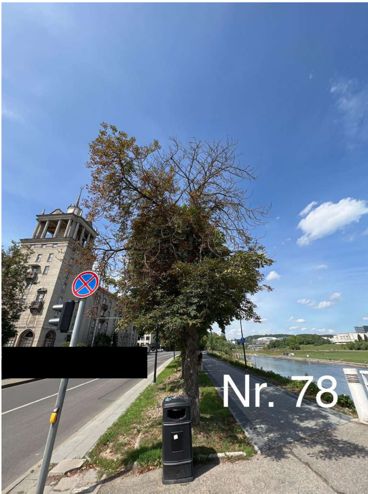
Paprastasis kaštonas (nr. 78 plane) - 50 procentų lajos yra sausa. Rekomenduojama atlikti lajos priežiūros genėjimą ir augavietės gerinimo (revitalizacijos) procedūras. Atlikinėti nuolatinį būklės monitoringą.
