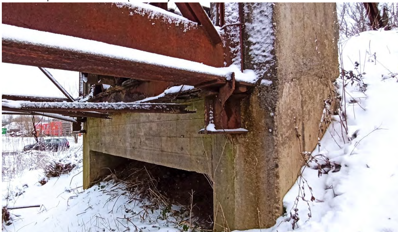
4 pav. Atraminių guolių bei perdangos ryšių defektai (Elektrinės g. pusėje).
