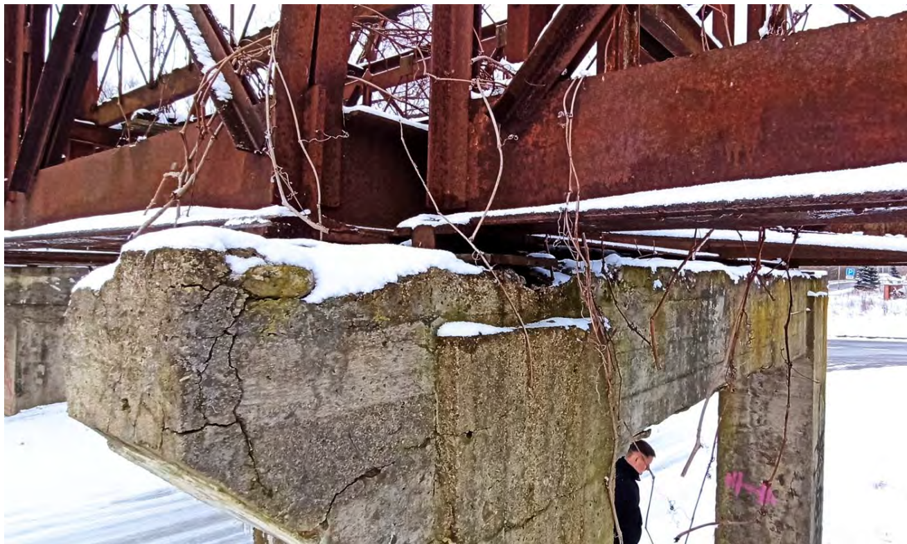
5 pav. Santvarų pasislinkimas nuo projektinės padėties. Atramų defektai (Elektrinės g. pusėje)
