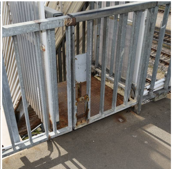
5 pav. Turėklų jungiamieji elementai paveikti korozijos.
