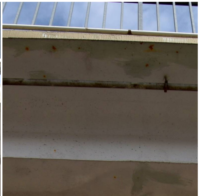
9 pav. Korozijos požymiai gelžbetoninĕs sijos lentynoje.
