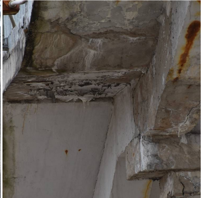
23 pav. Sueižėjęs betonas.
