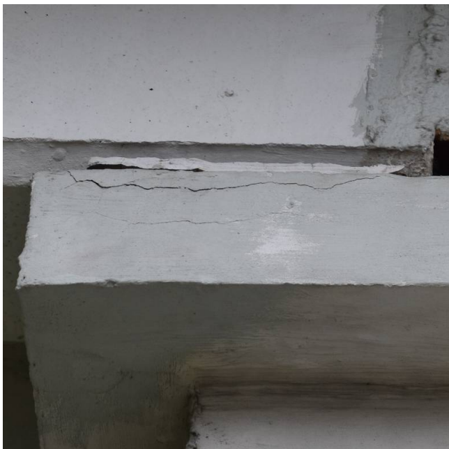
10 pav. Suskilinėjęs betonas g/b sijų atrėmimo plokštės kraštuose.
