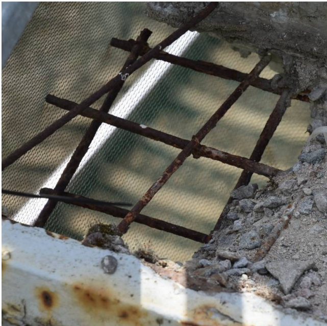
24 pav. Ištrupėjęs betonas.
