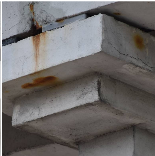
11 pav. Per plyšius atraminėje gelžbetoninėje plokštėje matomi korozijos židiniai.
