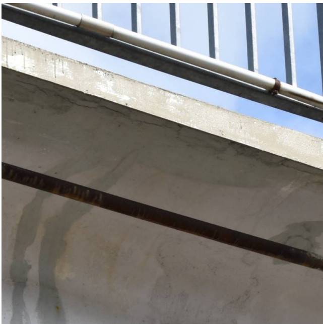
8 pav. Plyšiai gelžbetoninĕs sijos lentynoje.
