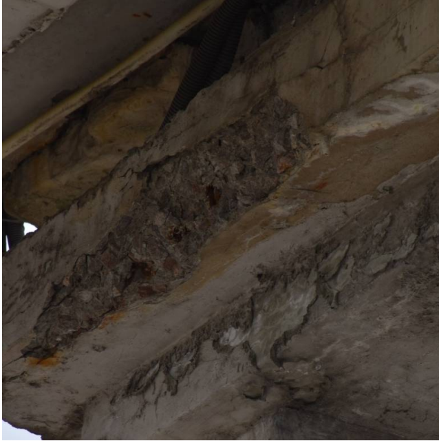
14 pav. Nutrupėjęs betonas nuo atrėminės plokštės kraštų
