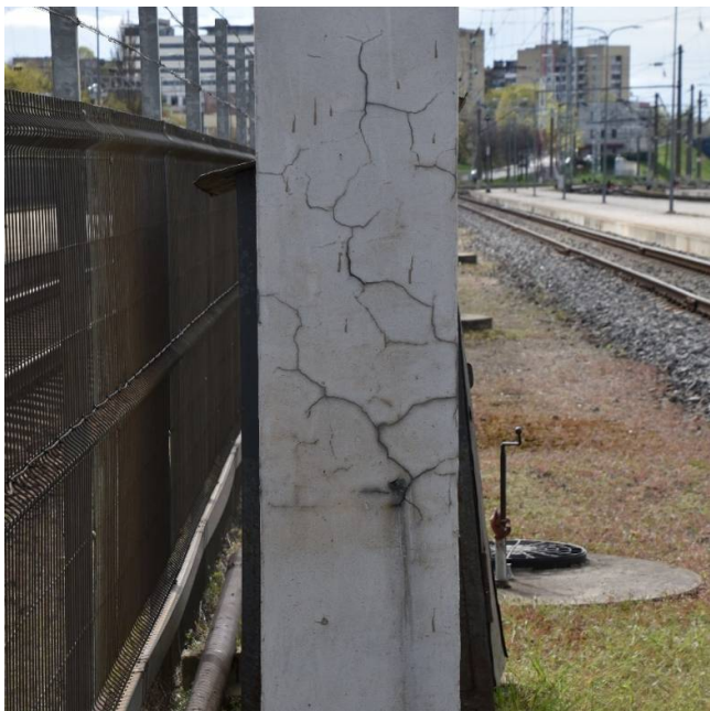
12 pav. Sueižėjęs kolonos apdailinis sluoksnis.
