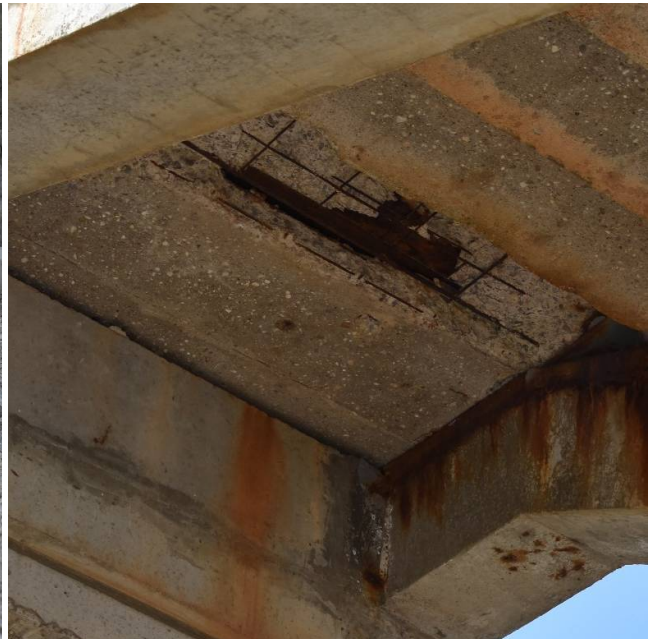
25 pav. Ištrupėjęs betonas.
