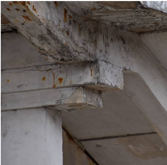
18 pav. Dėl aplinkos poveikio suskilinėjusi laptasija.. Išplitusi armatūros korozija.
