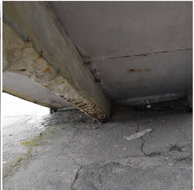
19 pav. Remontuotas, ir vėl atitrūkęs apsauginis betono sluoksnis. Koroduojanti armatūra.
