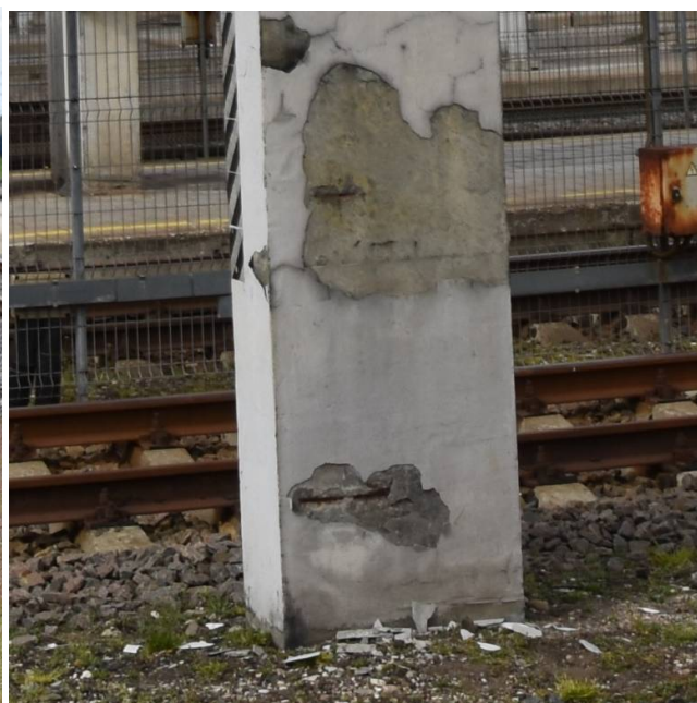
13 pav. Korozijos pažeista kolonos skersinė armatūra. Nukritęs kolonos apdailinis sluoksnis.
