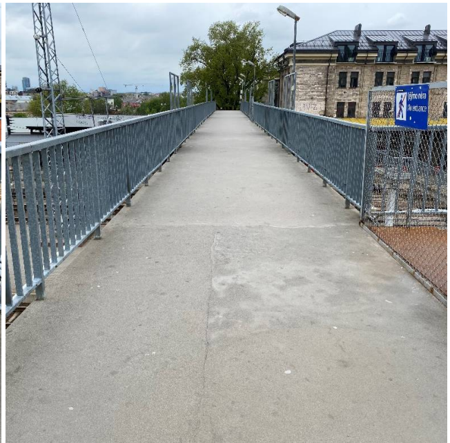
3 pav. Einamosios dalies dangos būklė gera (vaizdas nuo tilto vidurio link 1-ojo perono)
