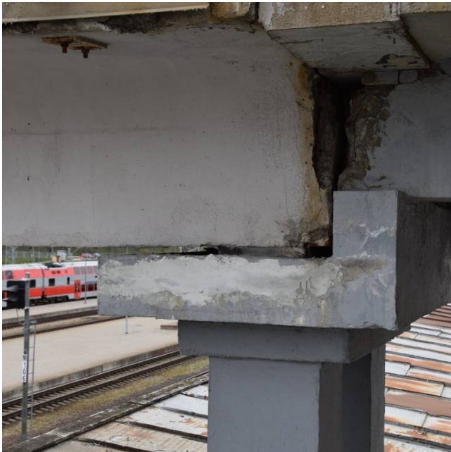
6 pav. G/b tĕjinĕs sijos atraminĕs dalies defektas. Atšokęs apsauginis betono sluoksnis ir koroduojanti armatūra.
