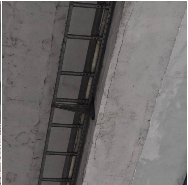
7 pav. G/b tĕjinĕs sijos išilginiai plyšiai sienelĕs apačioje prie pagrindinĕs armatūros.
