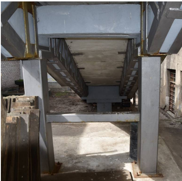
20 pav. Korozijos požymiai laiptasijų stiprinimo elementuose
