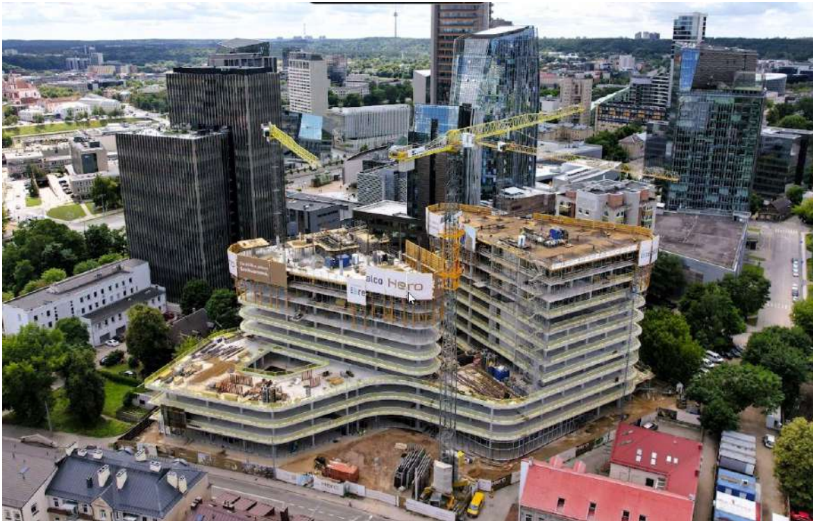
15 pav. Fotofiksacija iš drono 2024-06-20. Šiuo metu teritorijos prieigose yra vykdomi verslo centro „Hero“ statybos darbai, pagal statybos leidimą Nr.: LSNS-01-220406-00458
