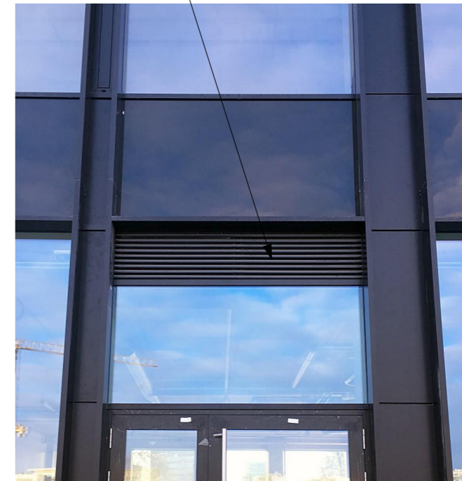
Horizontalių lamelių oro tiekimui į restorano vėdinimo sistemą pavyzdys:
