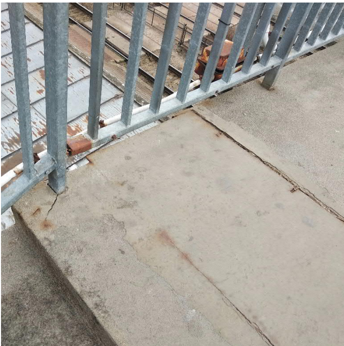
4 pav. Turėklų jungiamieji elementai paveikti korozijos.
