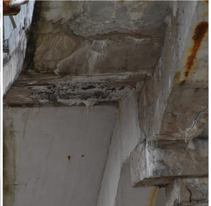
23 pav. Suižėjęs betonas.
