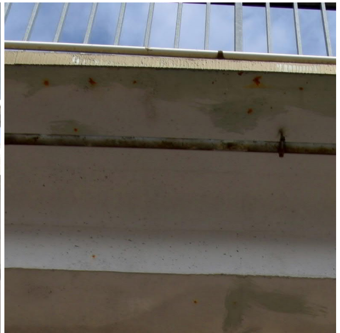
9 pav. Korozijos požymiai gelžbetoninės sijos lentynoje.
