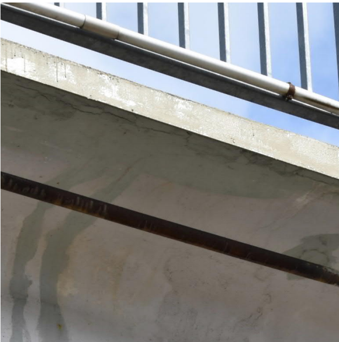
8 pav. Plyšiai gelžbetoninės sijos lentynoje.
