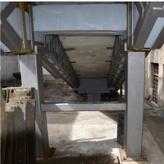
20 pav. Korozijos požymiai laiptasijų stiprinimo elementuose
