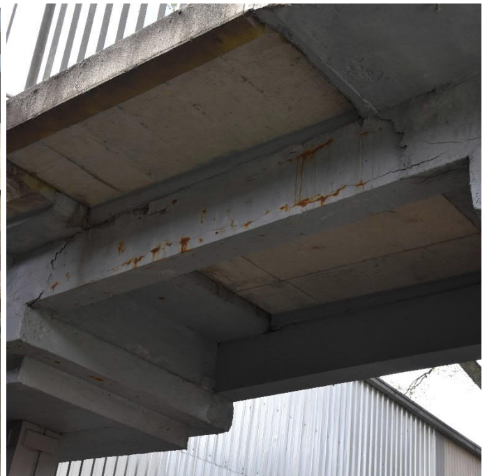
21 pav. Plyšiai laiptasijoje. Betonavimo defektai. Armatūros korozijos požymiai.
