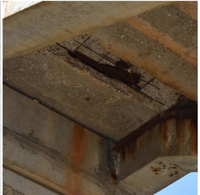
25 pav. Ištrupėjęs betonas.
