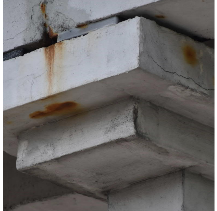
11 pav. Per plyšius atraminėje gelžbetoninėje plokštėje matomi korozijos židiniai.
