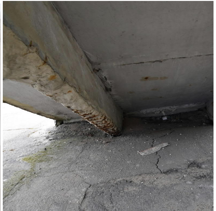
19 pav. Remontuotas, ir vėl atitrūkęs apsauginis betono sluoksnis. Korduojanti armatūra.
