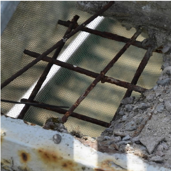
24 pav. Ištrupėjęs betonas.
