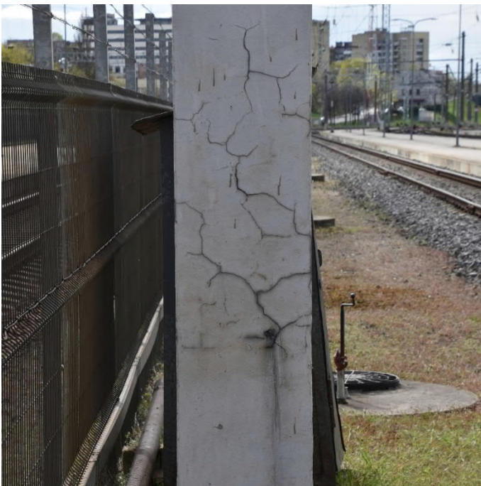
12 pav. Sueižėjęs kolonos apdailinis sluoksnis.
