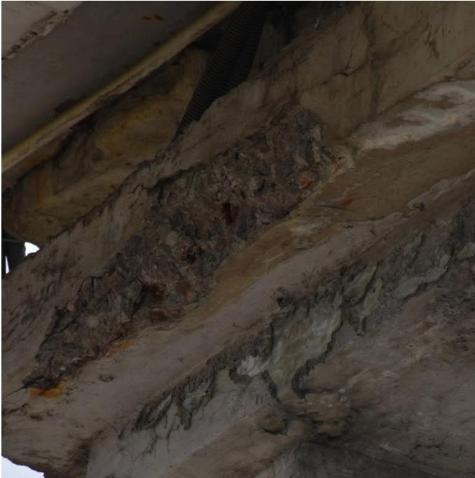
14 pav. Nutrupėjęs betonas nuo atrėminės plokštės kraštu
