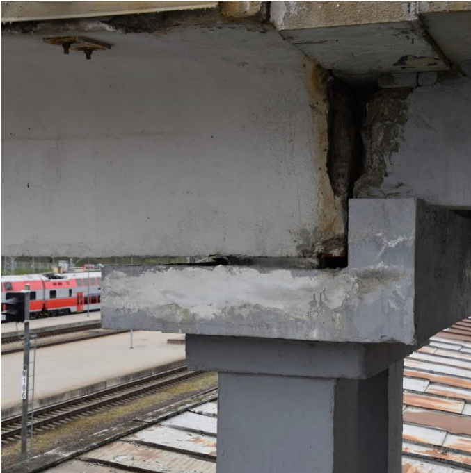
6 pav. G/b tĕjinĕs sijos atraminĕs dalies defektas. Atšokęs apsauginis betono sluoksnius ir koroduojanti armatūra.
