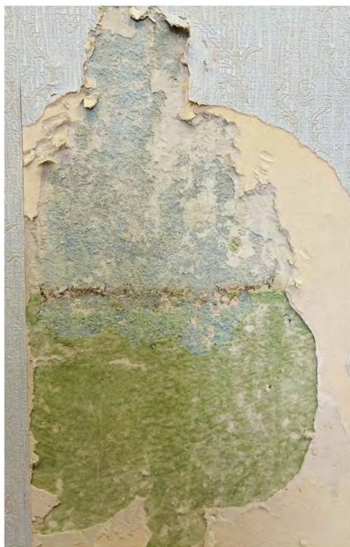
Fot. 2 Patalpa Nr. 3-3 Atodanga ant P sienos
