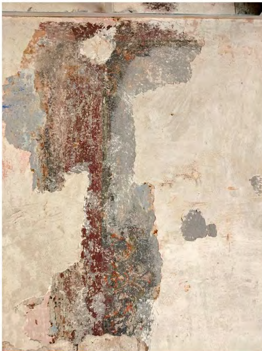
Fot. 18 Patalpa Nr. 3-11 Ankstyviausio sluoksnio atodanga ant Š sienos. Detalė
