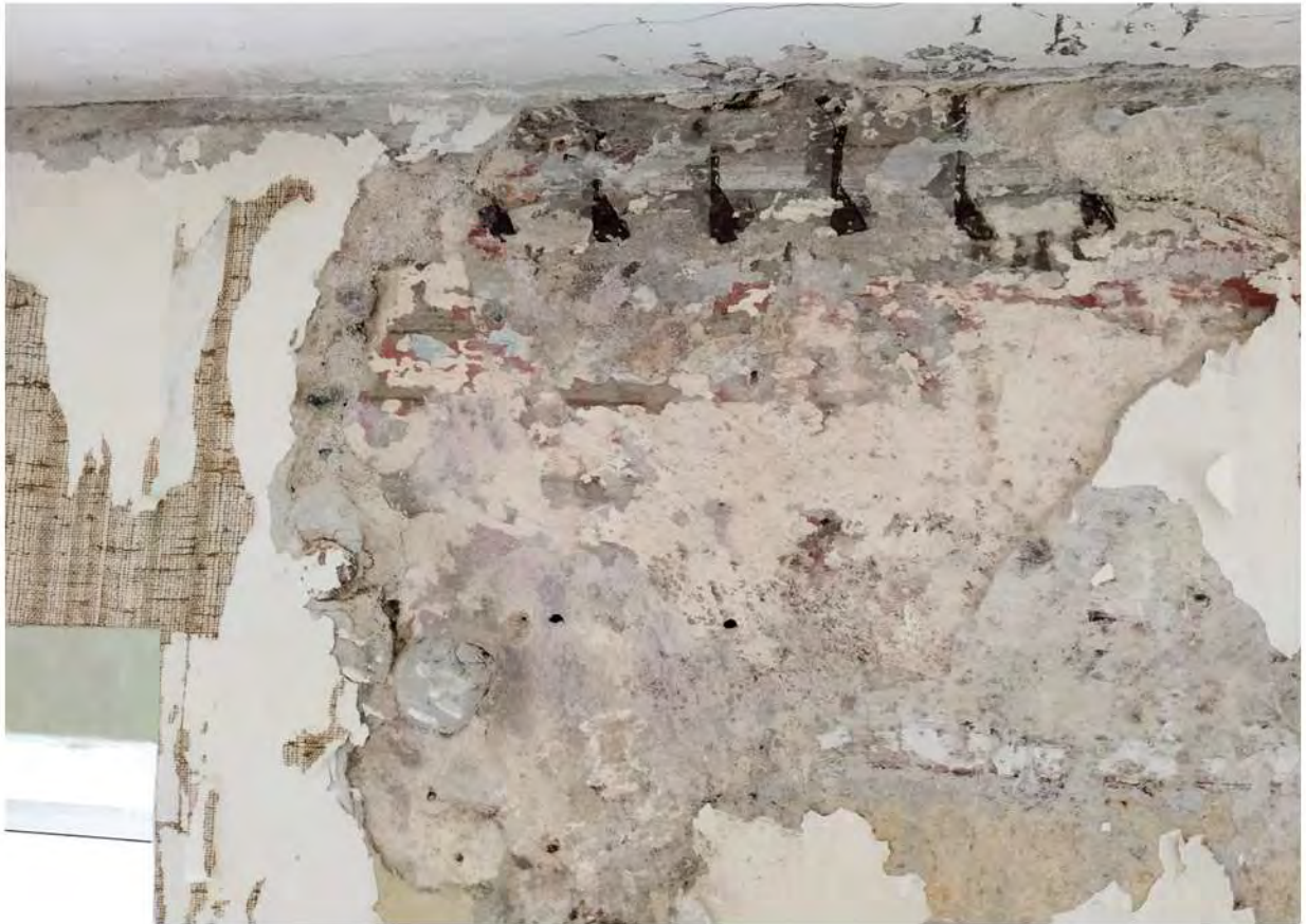
Fot. 9 Patalpa Nr. 3-5 Karnizo atodanga ant P sienos, tarp langu
