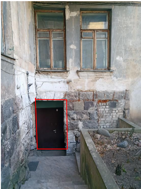
Apie 1967 m įrengiant pusrūsyje technines patalpas lango anga performinta į durų angą. (žiūr. pusrūsio inventorinį planą).
