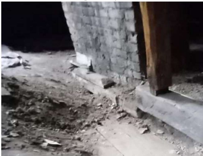
Pav. 5 C ašies stogo laikančios konstrukcijos apatinis ilginis – į ką atremtas neaišku.
