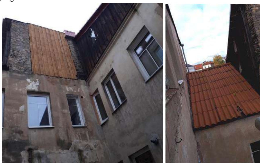
PV kiemelio vaizdas. Vidaus (buv. galerijos) PV kiemelio pietų ir vakarų fasadai. Projektuojamas butas trečiame aukšte ir pastogės dalis su istorine medinių lentų fasado apkala.
