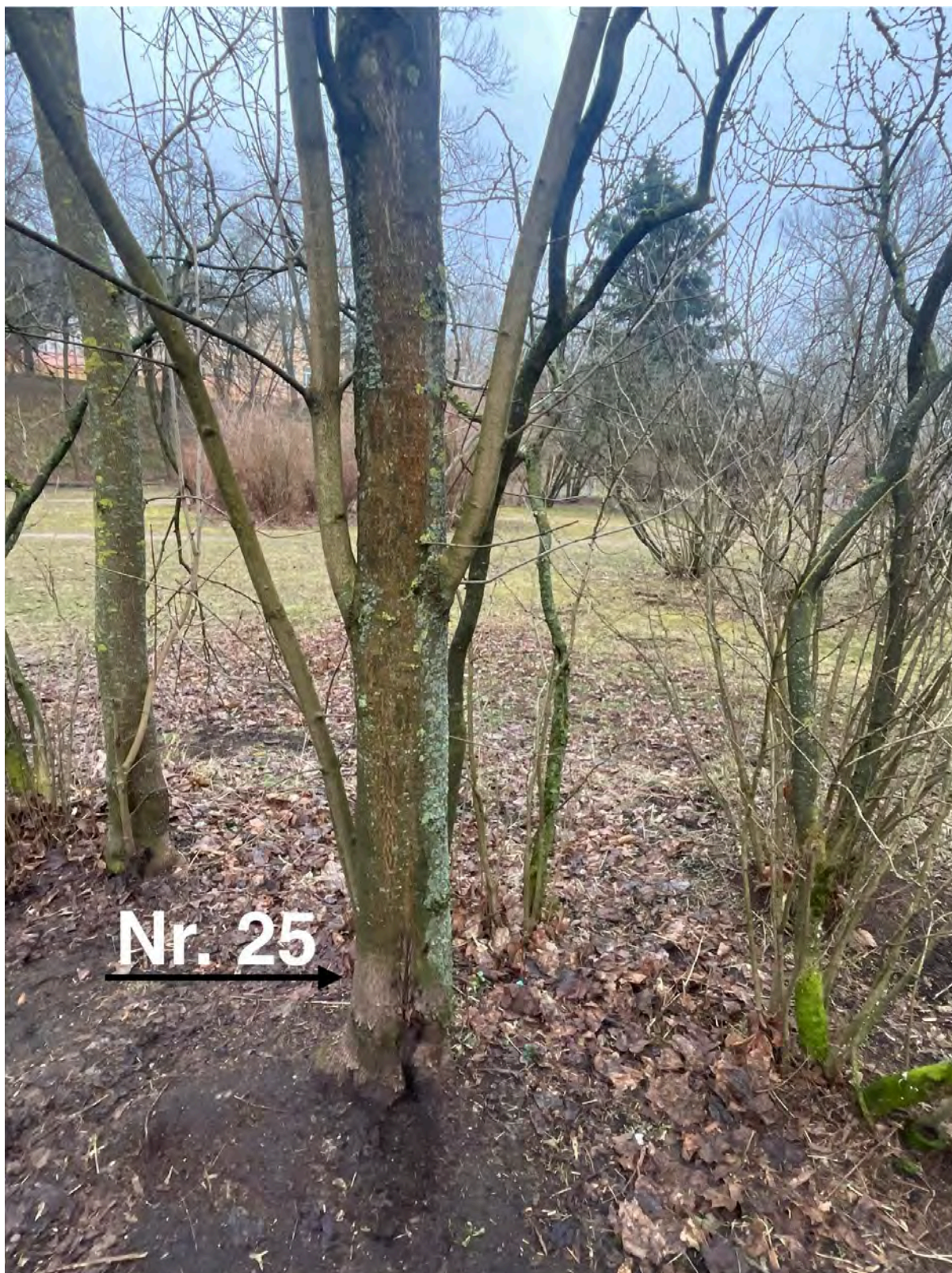
Mažalapė liepa (Nr. 25 plane) - Prasidėjęs kamieno kaklelio puvinys bei skilęs kamienas. Rekomenduojama atlikti lajos sanuojamąjį genėjimą bei kasmetinį būklės monitoringą dėl galimų pakitimų ateityje.
