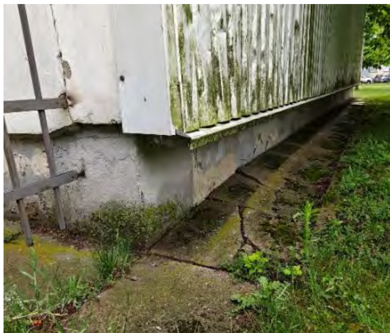
Pav 2. Cokolis įleistas į vidų kontakto, vyksta tinko erozija, zonose su gruntu matomi biologiniai pažeidimai
