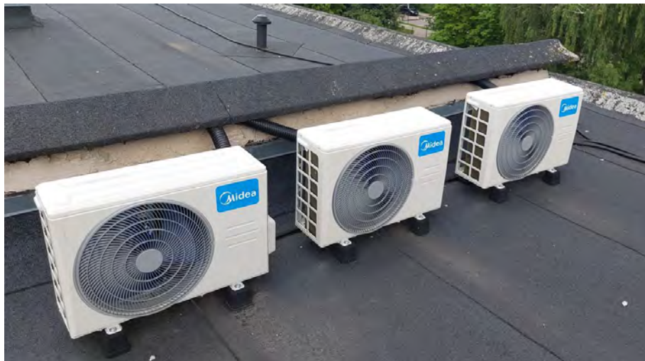
11 pav. Vėsinimo sistemų lauko blokai
