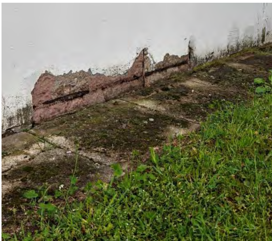
Pav 1. Cokolis pažeistas drėgmės
