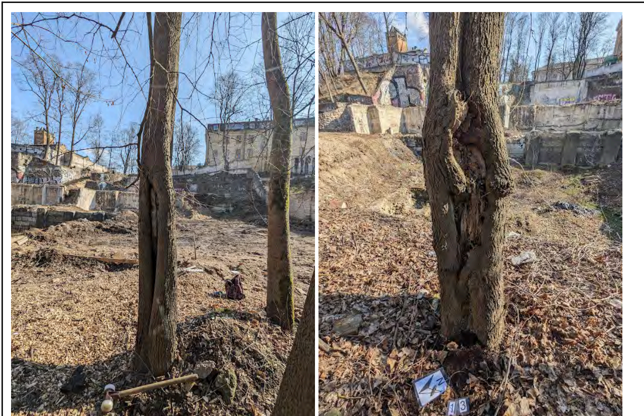
Pav. 4.1.4. Paprastieji klevai Nr. K8 ir K13 kamienne turi stambius mechaninius pažeidimus bei puvinius, todėl jiems rekomenduojama atlikti kasmetinį monitoringą.
