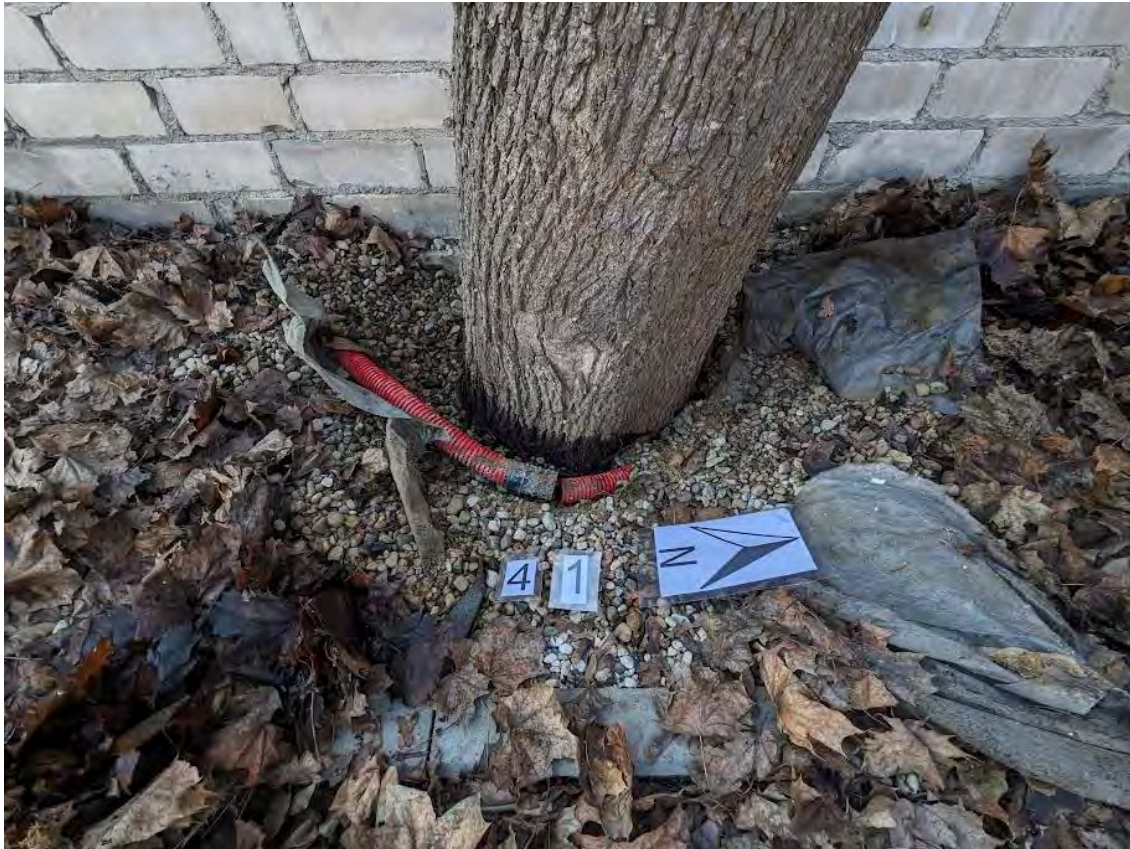
Pav. 4.5.2. Paprastojo klevo Nr. K41 augavietė smarkiai apribota kieta danga, užklota geotekstile ir užpilta žvyru. Padidėjusi puvinio tikimybė.
