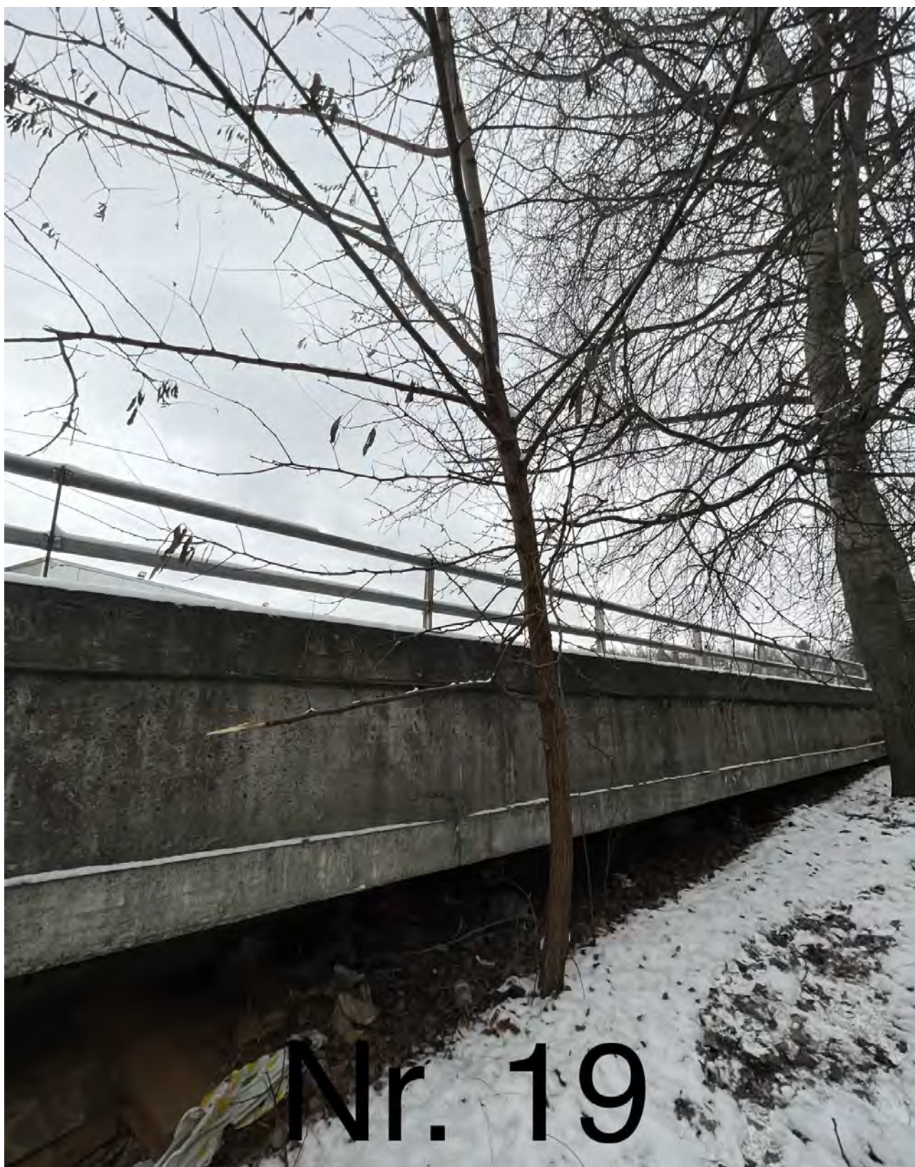
Baltažiedė robinija (nr. 19 plane) - kamienas pasviręs pietų kryptimi. Auga arti sienutės į kurią gali pradėti greitai trintis. Rekomenduojama atlikti pietinės lajos pusės redukcinį genėjimą iki 10 proc.
