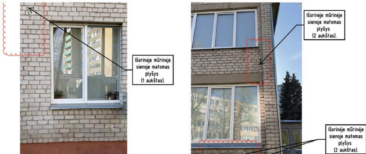
5 pav. Išorinės sienos plyšiai
