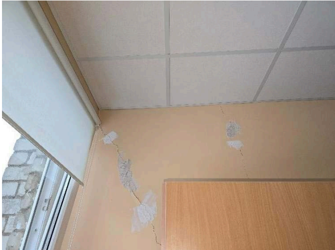
2 pav. Vidinės sienos plyšys (Nr. 25-10T)
