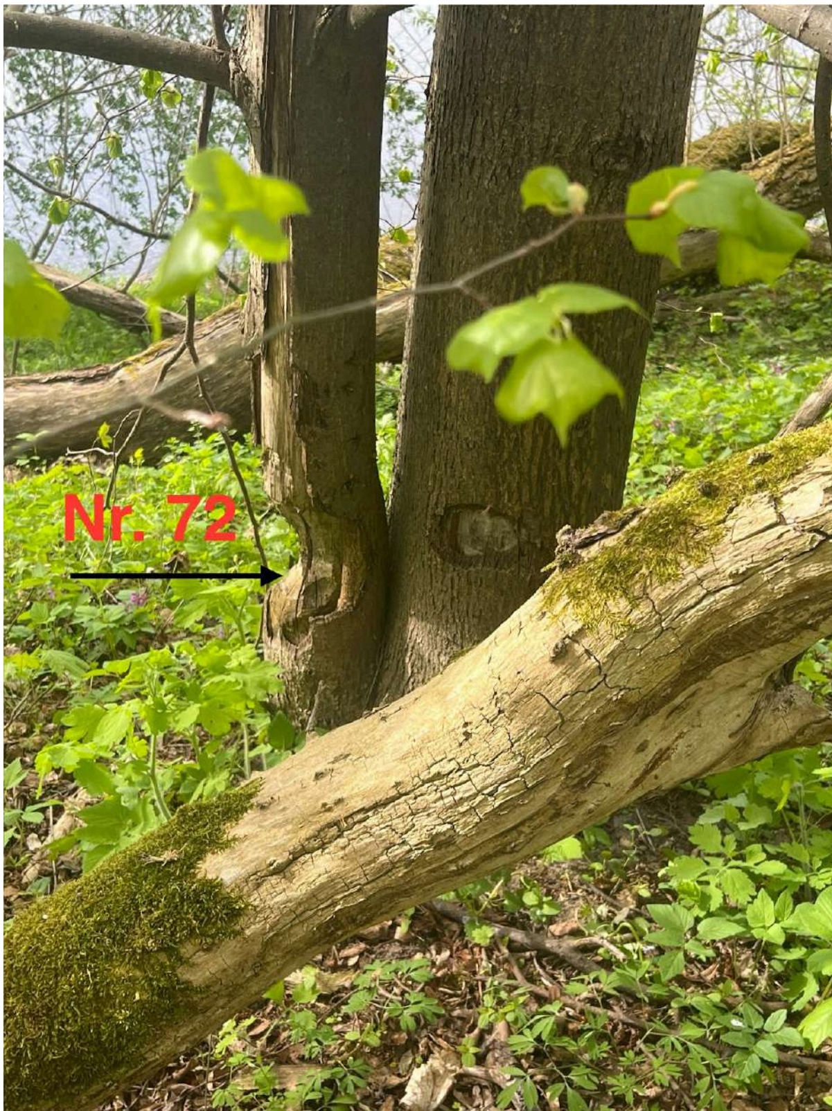
Mažalapė liepa (Nr. 72 plane) - bebrų smarkiai apgraužtas kamienas. Lajoje vidutinis kiekis sausų šakų. Į kamieną remiasi šalia augantis medis. Rekomenduojama atlikti minimalų lajos priežiūros genėjimą bei pašalinti pomedyje augantį medį. Taip pat reikia įrengti kamieno apsaugą nuo bebrų.
