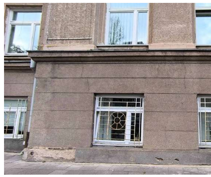
Esama cokolio būklė
