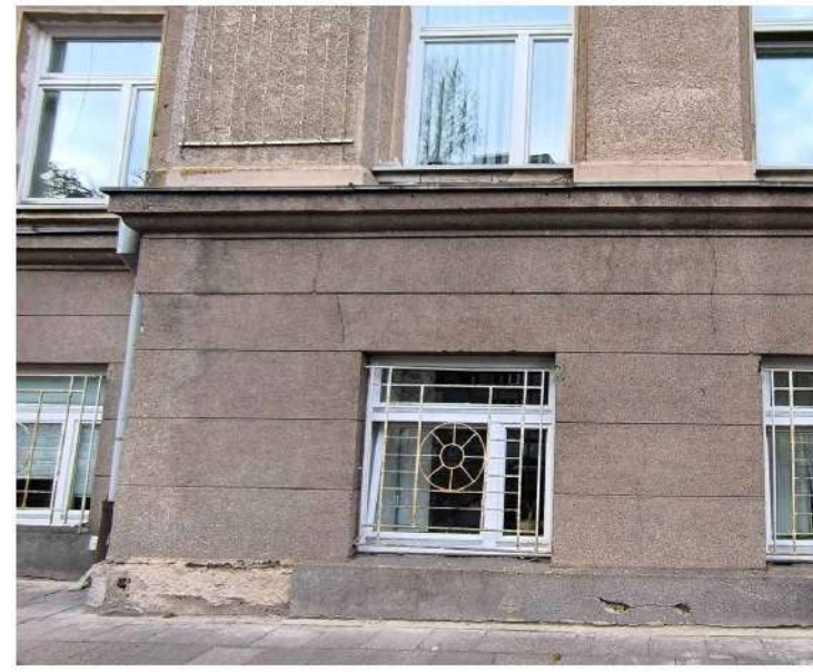
Esama cokolio būklė
