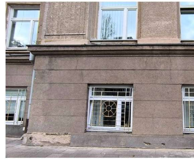
Esama cokolio būklė
